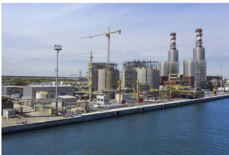
Deposito GNL - Ravenna.
